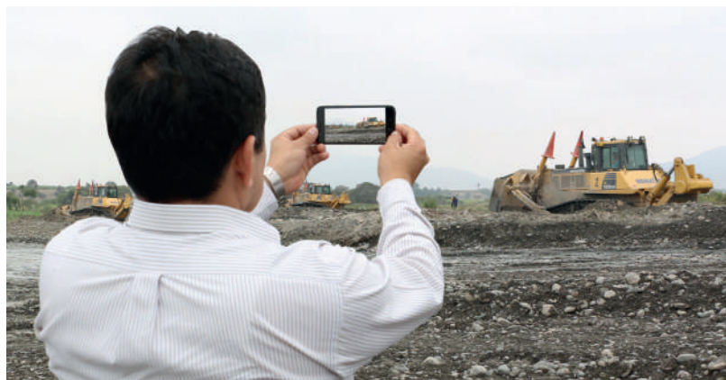
Los monitores de control ciudadano tendrán a su cargo la supervisión de las obras que se ejecutan en el marco de la Reconstrucción con Cambios
